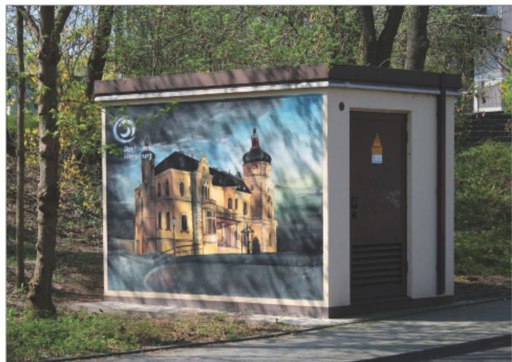
Bild 23: Fabrikfertige begehbare Station der Stadtwerke in Merseburg (ST), Wagnerstr./Preussenstr., Motiv: Schloss Foto: Wolfram Dittner
