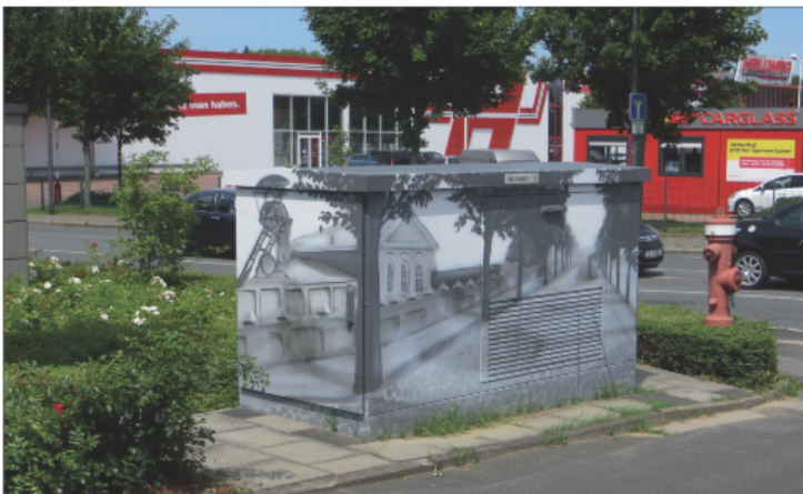
Bild 14: Fabrikfertige Kompaktstation der RWE Westnetz in Essen-Schönebeck, Aktienstr. Nr. 5.1, Motiv: Kohlenpott Foto: Westnetz
