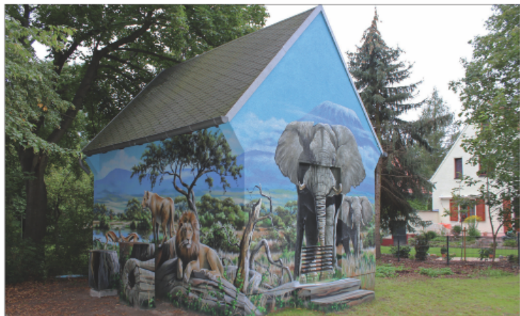
Bild 11: Transformatorstation der E.ON-edis in Kleinmachnow (BB), Ginsterteheide-Wolfswerder, Motiv: Großwild in Afrika Foto: Markus Ronge
