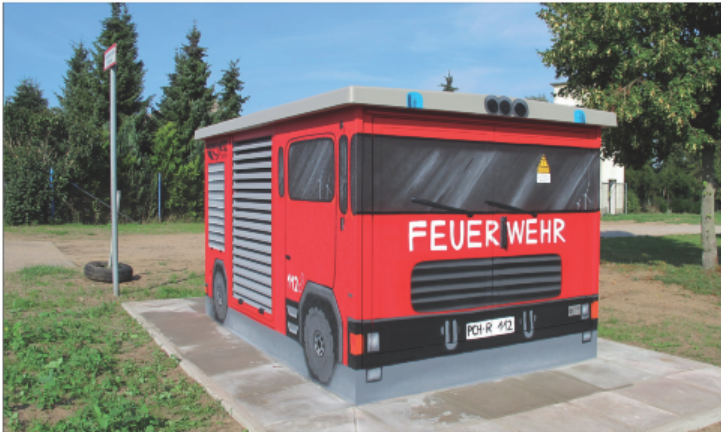
Bild 7: Fabrikfertige Kompaktstation der WEMAG Netz in Raduhn (MV), Lindenstr., Motiv: Feuerwehrauto Foto: Sebastian Voglmann/Michael Recht
