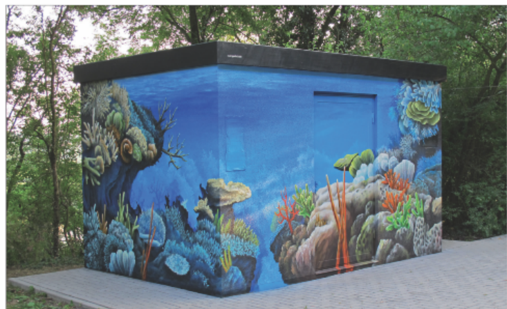
Bild 17: Fabrikfertige begehbare Station der Rhenag in Siegburg (NW), Tal-sperrstr., Motiv: Unterwasser-Meeresriff Foto: Swen Gerisch
