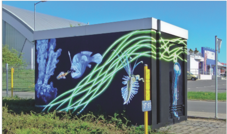
Bild 4: Fabrikfertige begehbare Trafostation der Stadtwerke in Meerane (SN), Guteborner Allee, Motiv: Tiefseetiere
