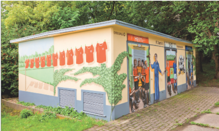
Bild 1: Transformatorstation der Stadtwerke in Dresden (SN), Spartenweg, Motiv: Fußballclub
