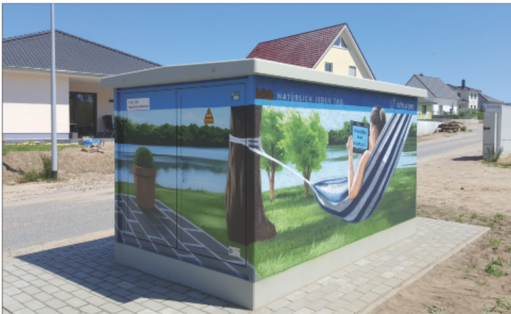
Bild 8: Fabrikfertige Kompaktstation der Stadtwerke in Schwerin (MV), Büdnerstr., Motiv: High Speed Dank Glasfaser Foto: Cristian Pursch
