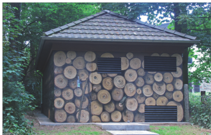
Bild 18: Transformatorstation der Rhenag in Siegburg (NW), Viehtrift, Motiv: Baumstämme im Wald Foto: Swen Gerisch
