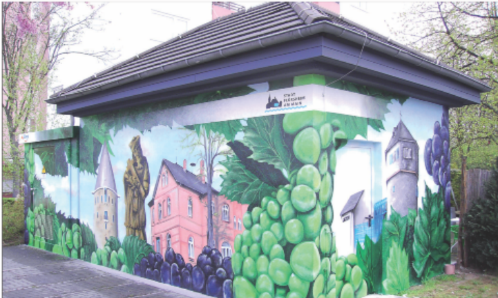
Bild 19: Transformatorstation in Flörsheim (HE), Motiv: Weintrauben und Burgen Foto: Marcus Dörr
