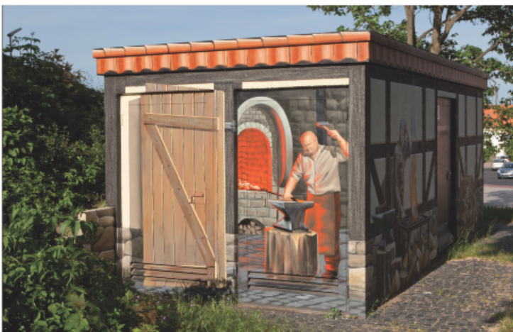
Bild 15: Fabrikfertige begehbare Station der E.ON-Avacon in Schöningen (NI), Burgplatz, Motiv: Alte Schmiede Foto: Norbert Pernier
