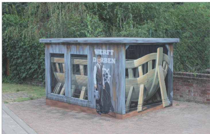
Bild 12: Fabrikfertige Kompaktstation der E.ON-Avacon in Stendal-Derben (ST), Friedensplatz, Motiv: Bootsbau Foto: Markus Ronge
