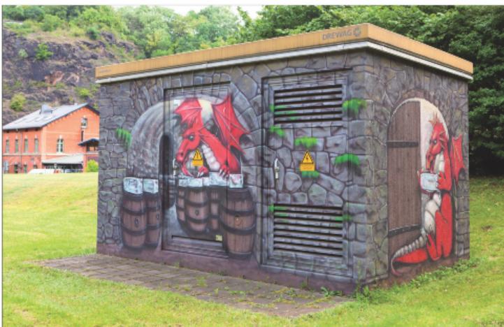
Bild 3: Fabrikfertige begehbare Trafostation der Stadtwerke in Dresden (SN), Tharandter Str., Motiv: Drachenkeller
