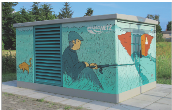
Bild 6: Fabrikfertige Kompaktstation der WEMAG Netz in Leritzwand-Matzlow (MV), Lewitzweg, Motiv: Fischer
