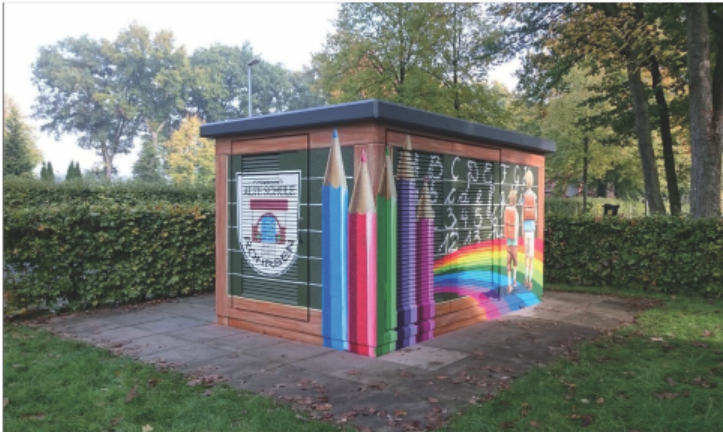
Bild 13: Fabrikfertige Kompaktstation der E.ON-Avacon in Rohrsen (NI), Alte Schule, Motiv: Malstifte Foto: Daniel Siering
