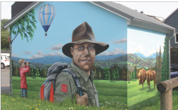
Bild 20: Transformatorstation der RWE Westnetz in Bad-Berleberg (NW), Limburgstr. 14, Motiv: Wanderer in den Bergen Foto: Westnetz
