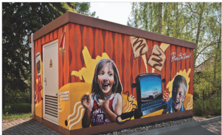
Bild 5: Fabrikfertige begehbare Trafostation der Stadtwerke in Meerane (SN), Glauchauer Str., Motiv: Kinder im Netto-Markt
