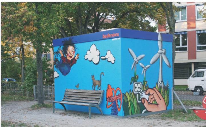
Bild 21: Fabrikfertige begehbare Station der badenova in Freiburg (BW), Tennenbacherstr., Motiv: Erneuerbare Energie am Kinderspielplatz Foto: Andreas Ernst
